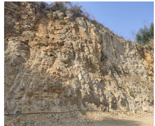
边坡需及时进行治疗防护
