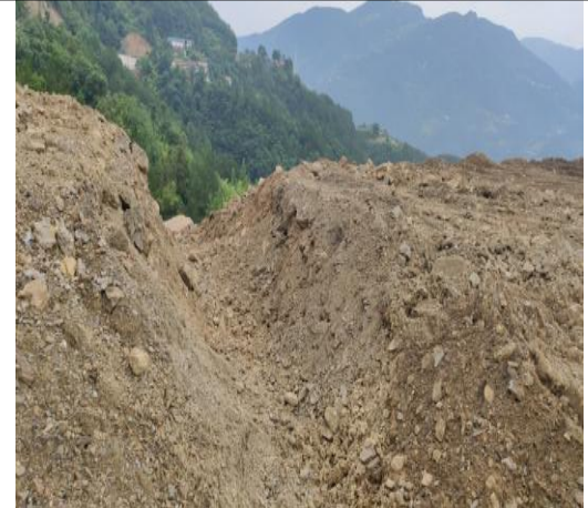
弃渣场土质排水沟
