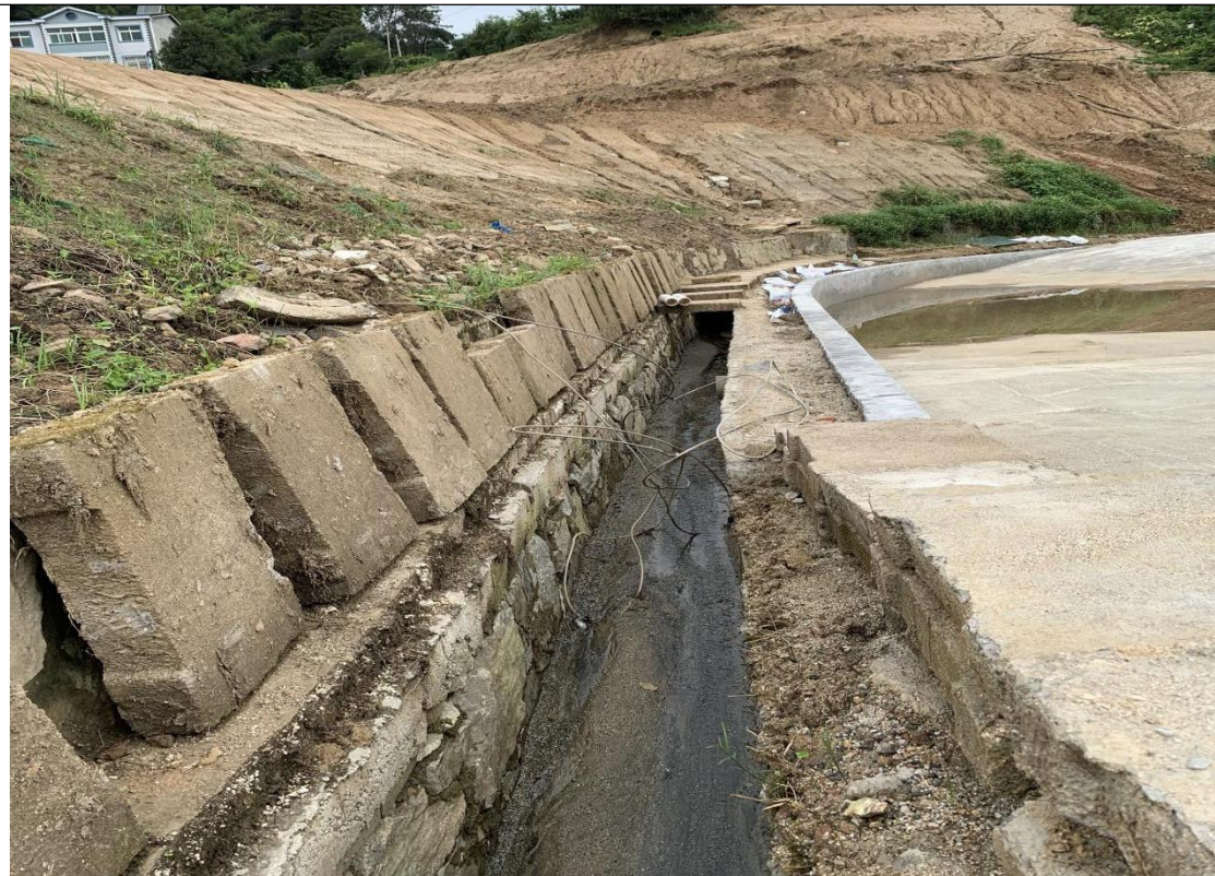
明珠大道原排水沟
