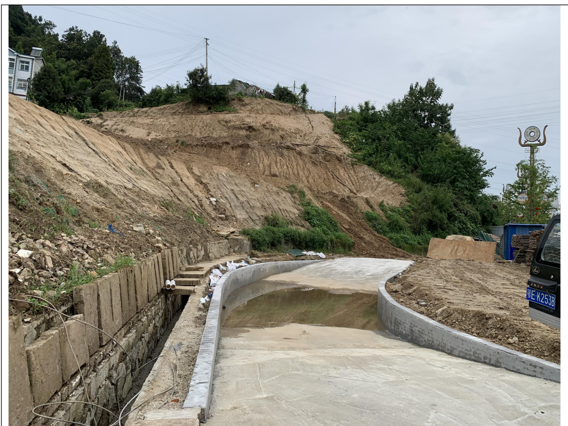
一期场区出口洗车池
