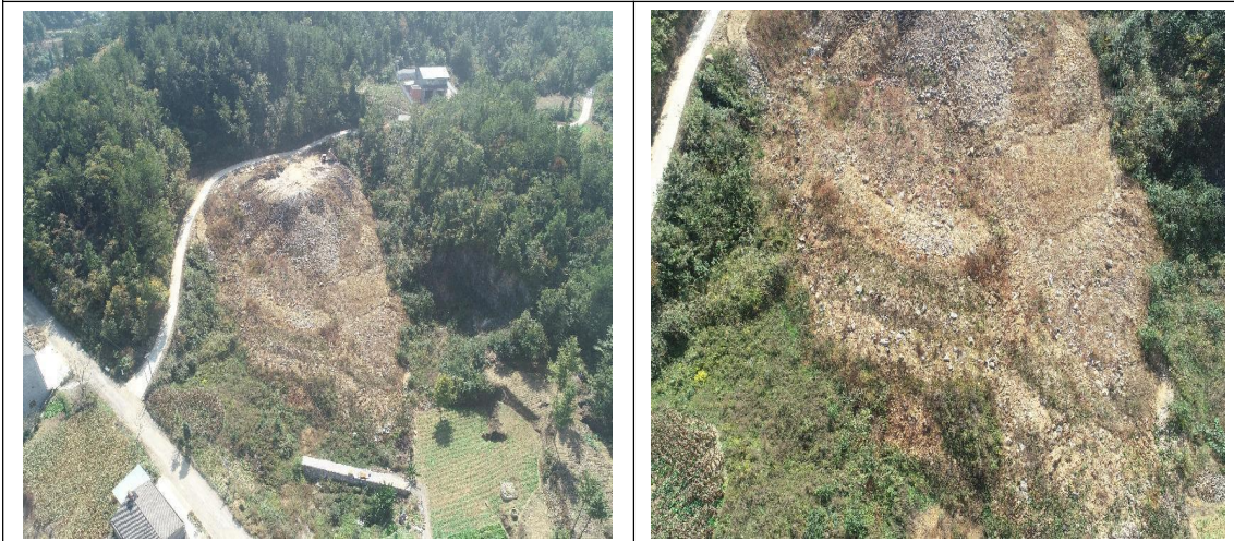
K21+920 弃渣场（需及时进行土地整治、修建截水沟，完善植物措施）
