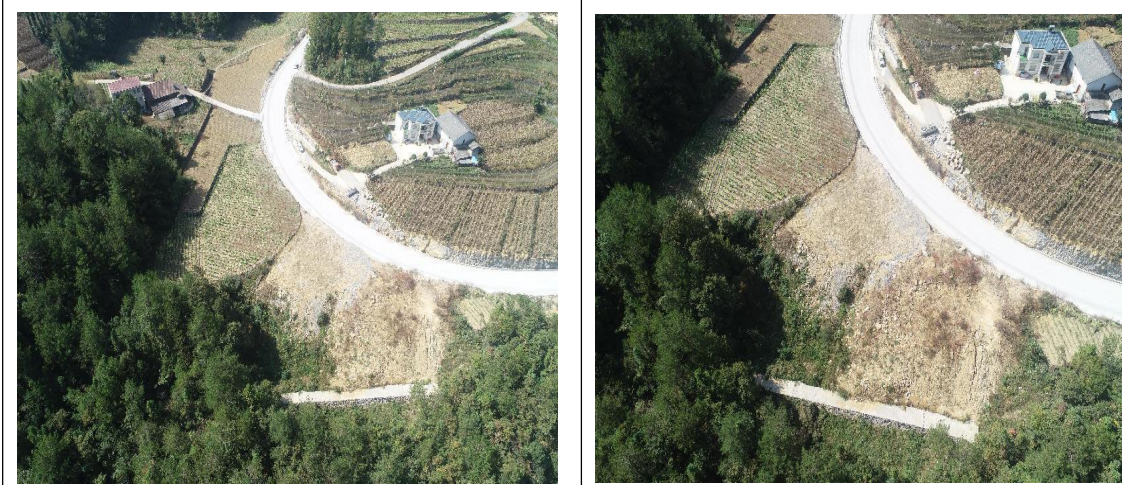
K21+080 弃渣场（需及时进行修建截水沟、进行植被恢复）
