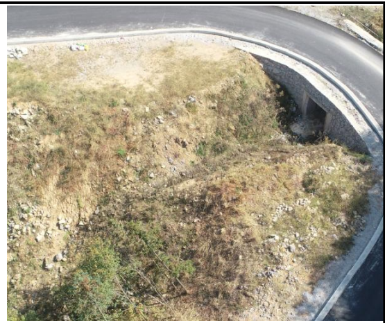
K14+140 弃渣场 (建议增加挡排措施)
