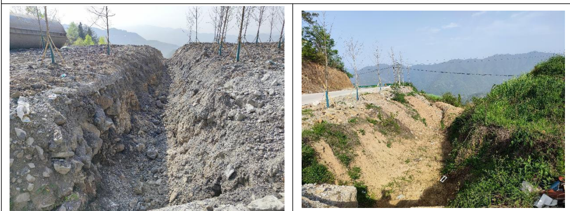
K12+438 弃渣场排水沟
