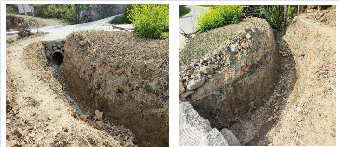
K19+520 弃渣场排水沟
