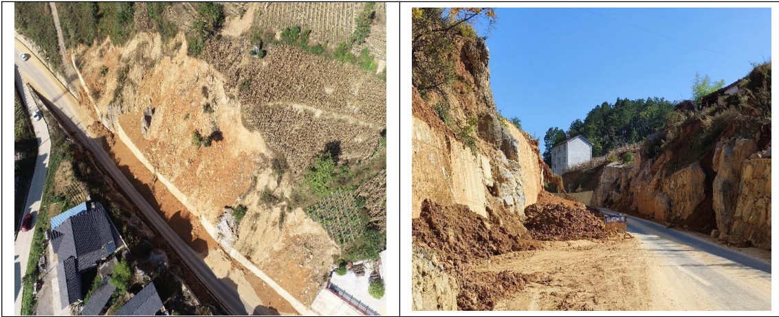
边坡坍塌及时清理
