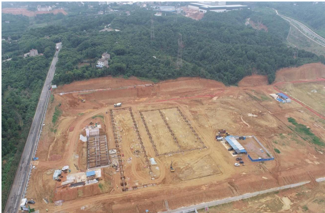
已建云保路（左侧）、建设中的石墨系列产品项目、高压走廊（上部）
