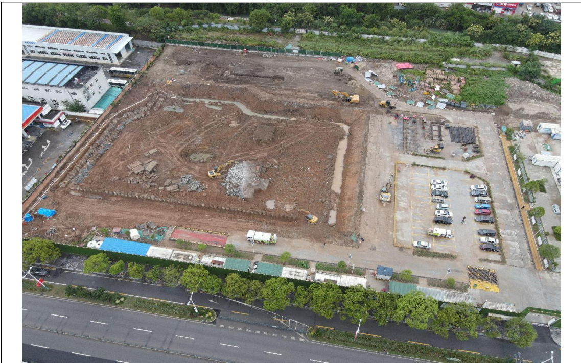
项目区航拍图（2023.9.15）
