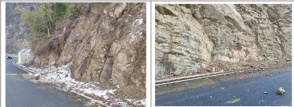
路基排水沟内碎石需清理
