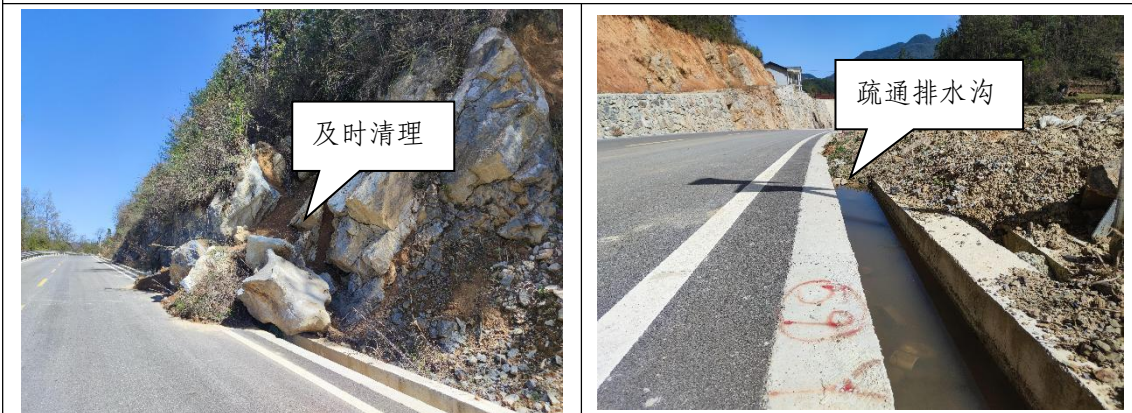
路基排水沟内碎石需清理
