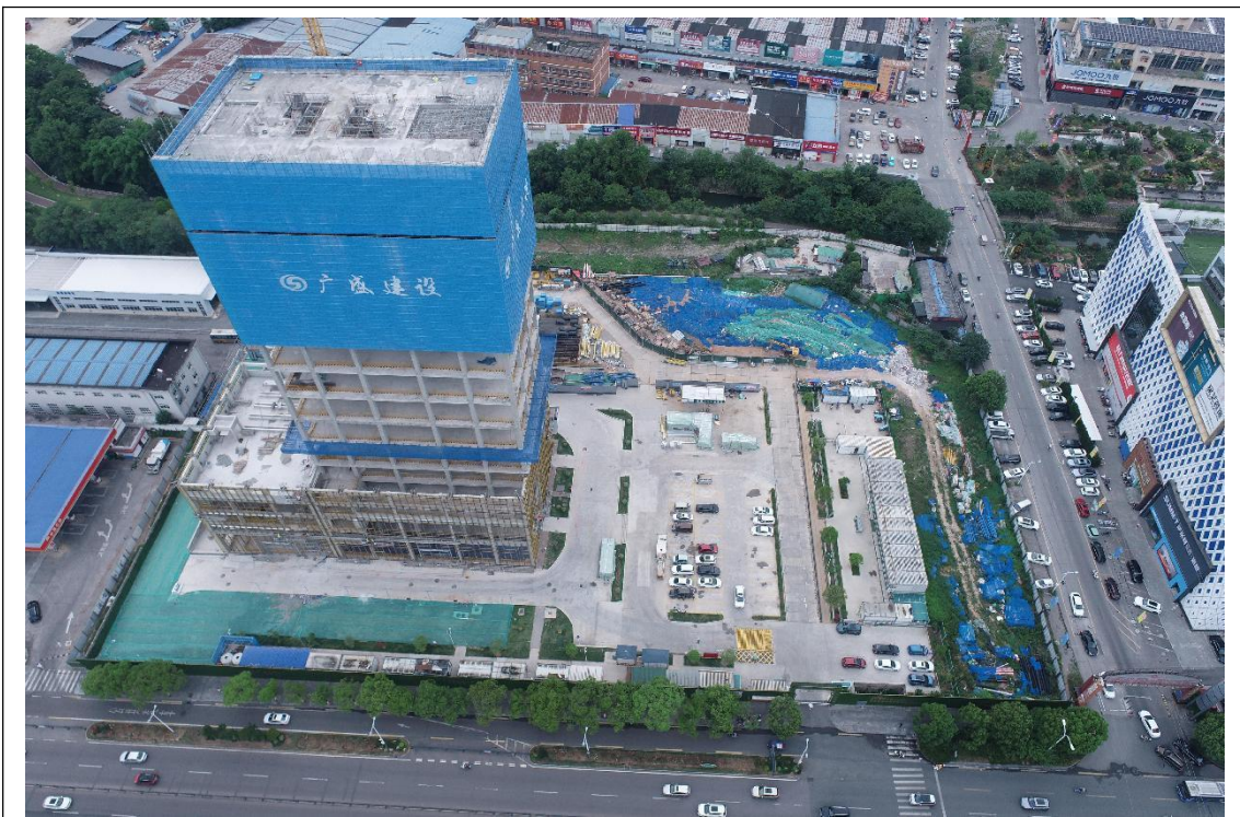
项目区航拍图（2023.6.25）
