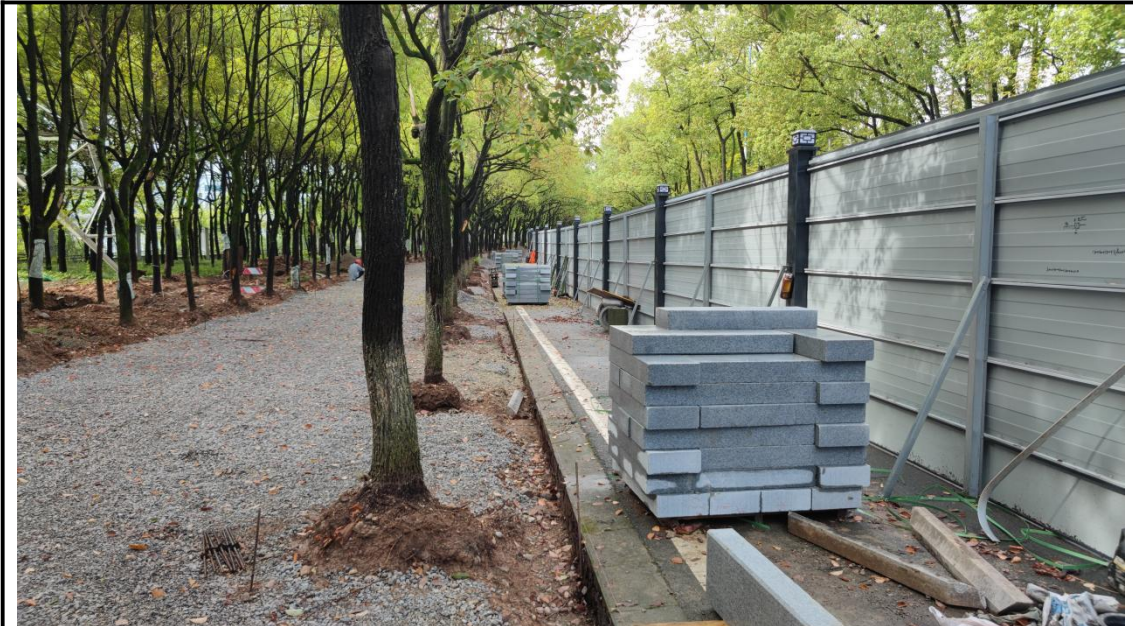
临时排水沟（2023年6月）
