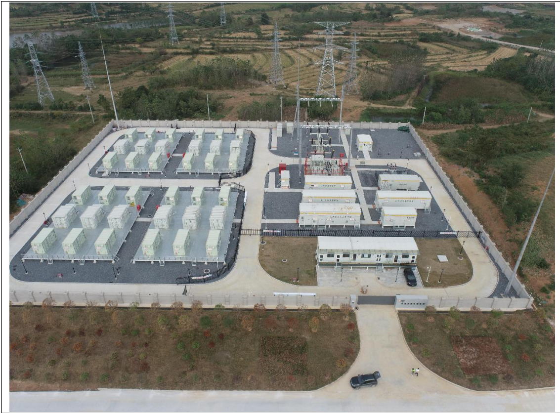
升压站区航拍图
