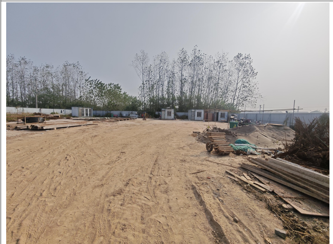
施工生产生活区硬化未清除
